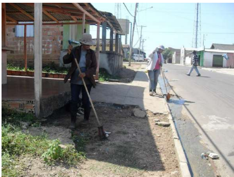
ILUSTRAÇÃO 4.2.3.2 – TRABALHADORES COM EPIs INCOMPLETOS. (FONTE: TCE/AM)
